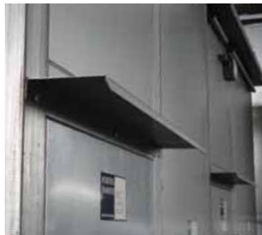
Крыша инспекционной двери
